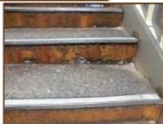
横断歩道橋蹴上り(補修前)
