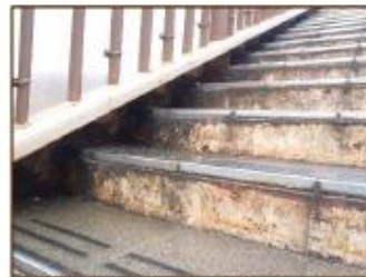
横断歩道橋蹴上り(補修前)
