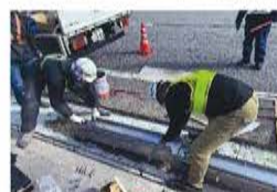
⑤流水部設置
